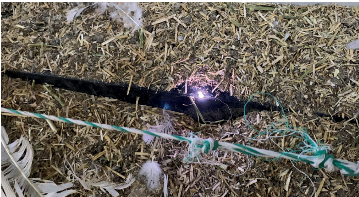
Figuur 15: Schrikdraad op de grond van een pluimveestal. De vonken kunnen door de directe nabijheid van brandbaar materiaal tot brand leiden. (Bron: Technisch Bureau Blanke (TBB))
