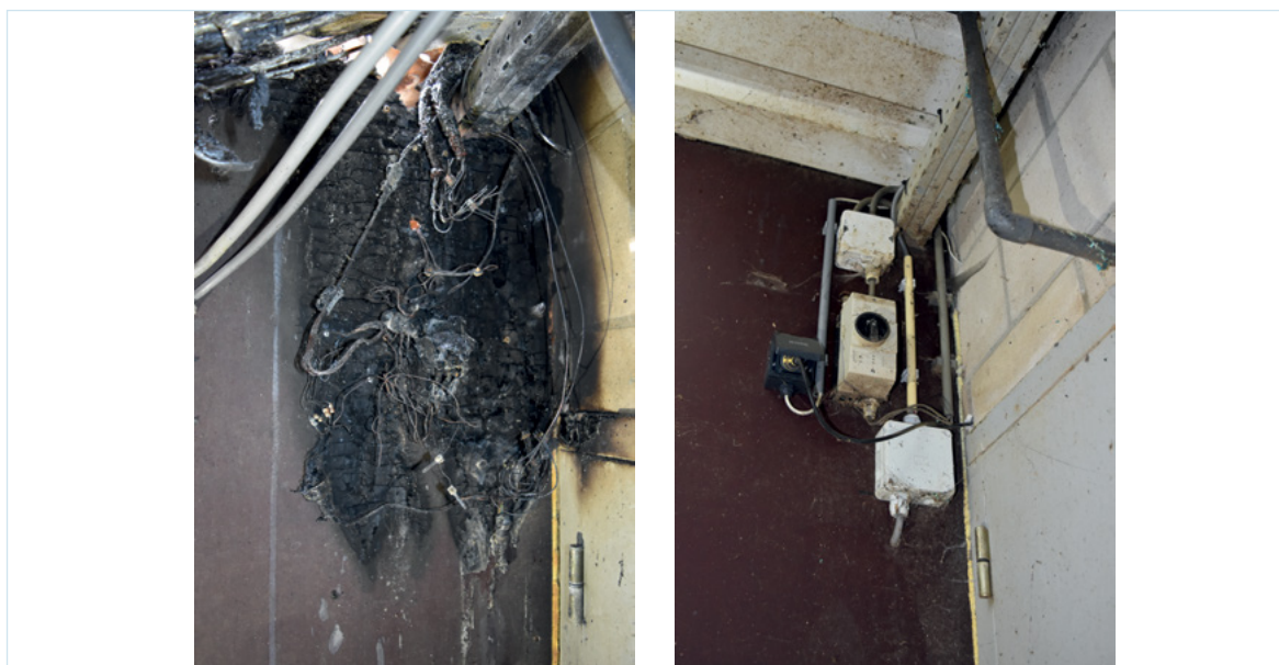
Figuur 14: Links: de verbrande schakelaar, met linksboven in de foto twee nieuwe kabels die na afloop van de brand als noodreparatie zijn aangebracht. Rechts: een identieke maar niet-verbrande schakelaar van een ventilator in de werkgang van de stal. Te zien zijn een schakelaar met bijbehorende bedrading en lasdozen van een dakventilator. (Bron: TBO Brandweer Zeeland)
