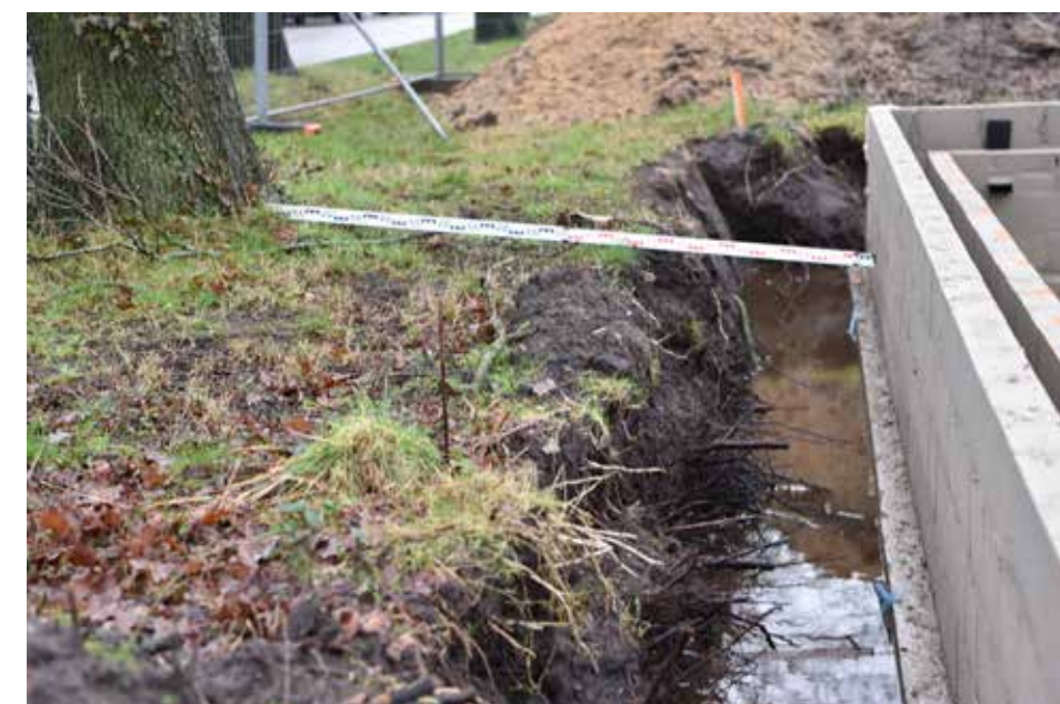
Wortelschade door graafwerkzaamheden voor fundering (fotograaf Martijn Hoogendoorn).
