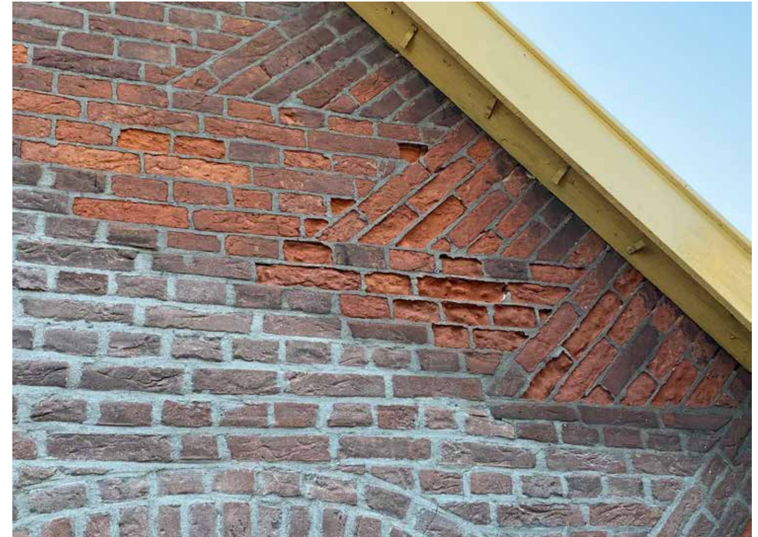
Cementgebonden voegwerk in een met kalk gemetselde gevel.
