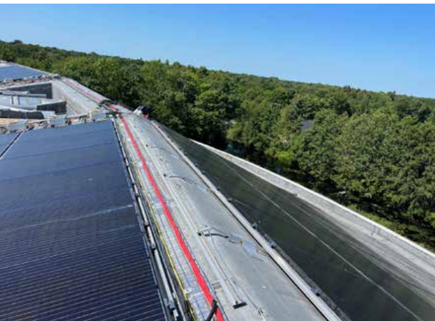
Zonnepanelen op het Thialf gebouw.
